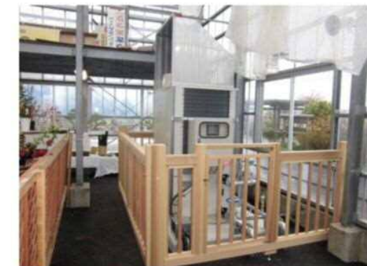
導入したヒートポンプ 出所) 新潟市魅力発見サイト「ガタブラ」
